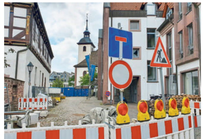
Auch die Nebenstraßen werden saniert oder dienen als Lagerstätte für Baumaterial, Steine und Bauwagen.
