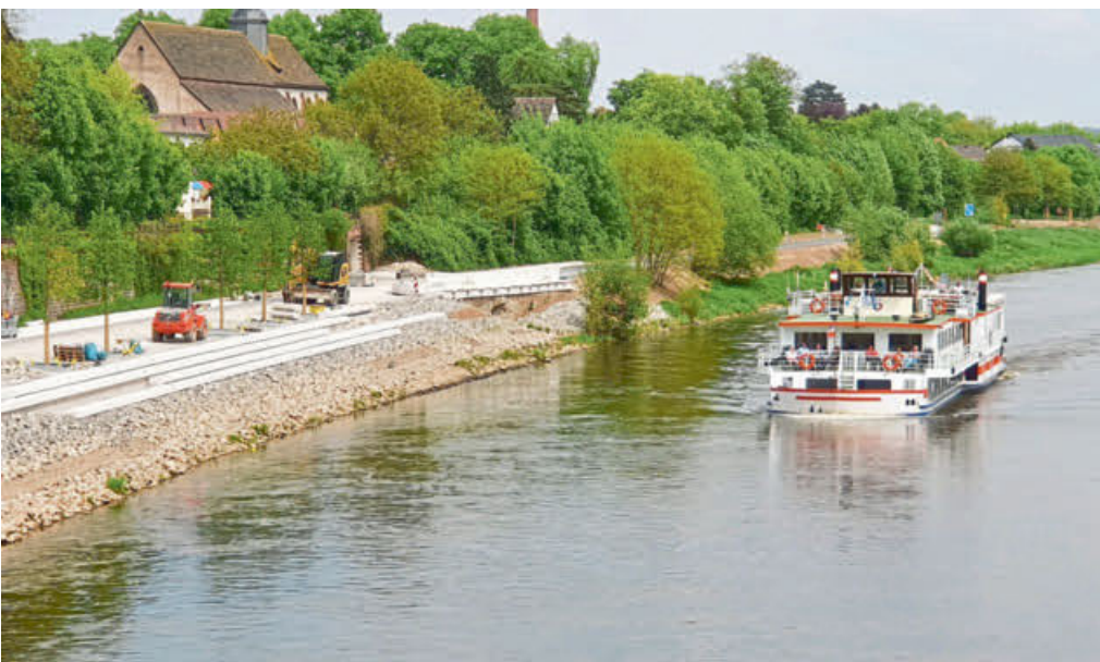
Ein Teil der Landesgartenschau-Baustellen an der Weserpromenade in Höxter: „Die längste Bank in NRW“ wird hier gerade gebaut. Hier können die Besucher Richtung Solling und Wesertal blicken.
