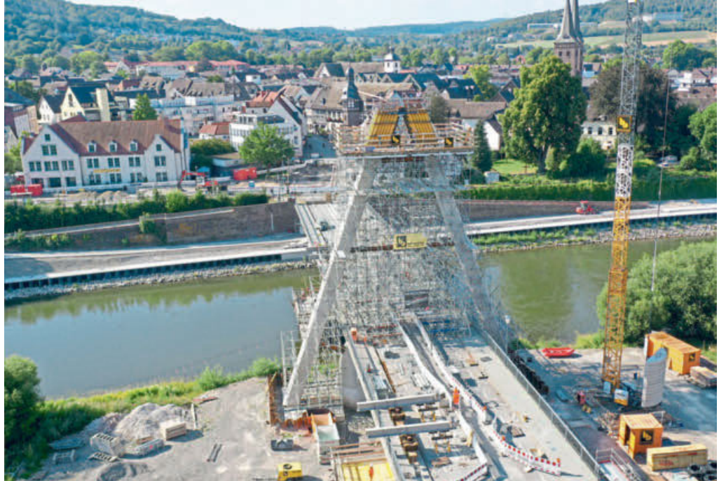
36 Meter hoch wird der neue Pylon der Weserbrücke in Höxter. An dem Träger werden Stahlseile befestigt, die der 1956 errichteten Spannbetonbrücke neue Stabilität geben sollen. Foto: Thomas Kube
