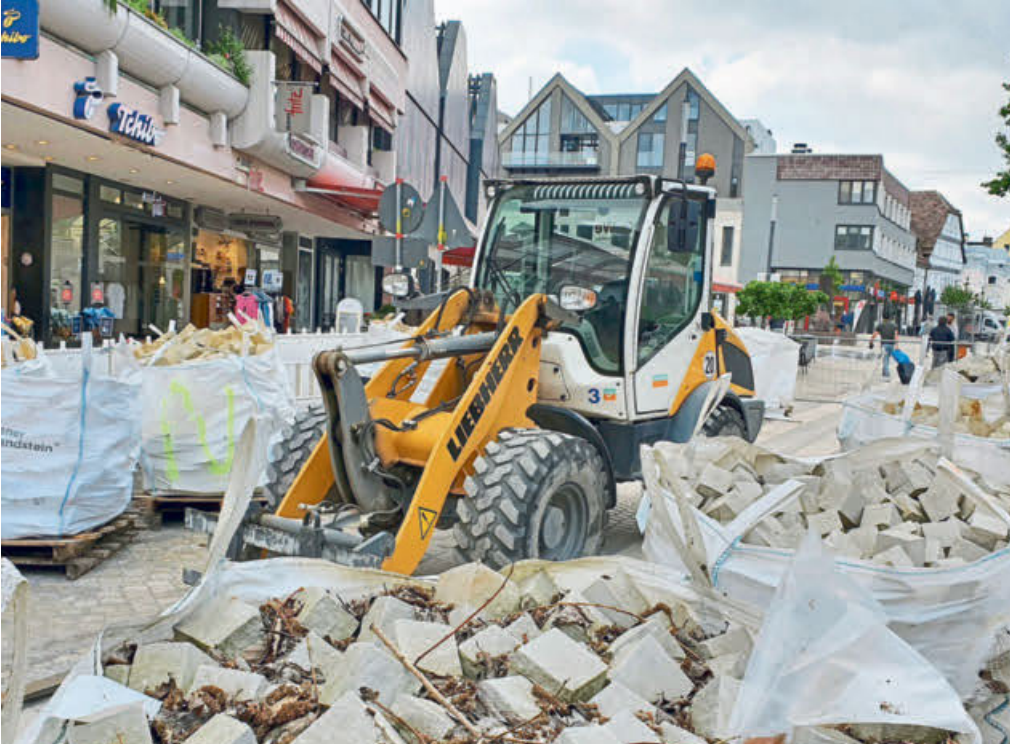
Schon zwei Jahre ist die Innenstadt eine Großbaustelle: Zurzeit wird überall das neue helle Pflaster verlegt. Zur Gartenschaueröffnung im April 2023 soll alles fertig sein. Alle Fotos: Michael Robrecht
