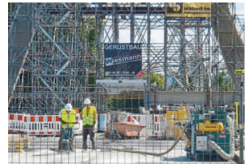
Auch bei 35 Grad im Schatten haben in diesem heißen Sommer 2022 die Bauleute gearbeitet.
